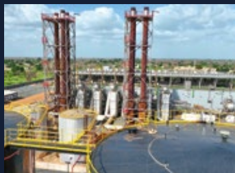
☉ Centrale électrique de Malicounda, Sénégal
